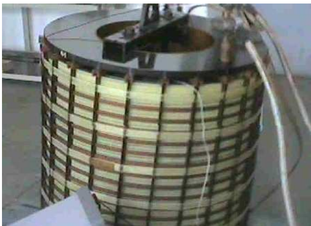
катушка перед высушиванием «DC» током
